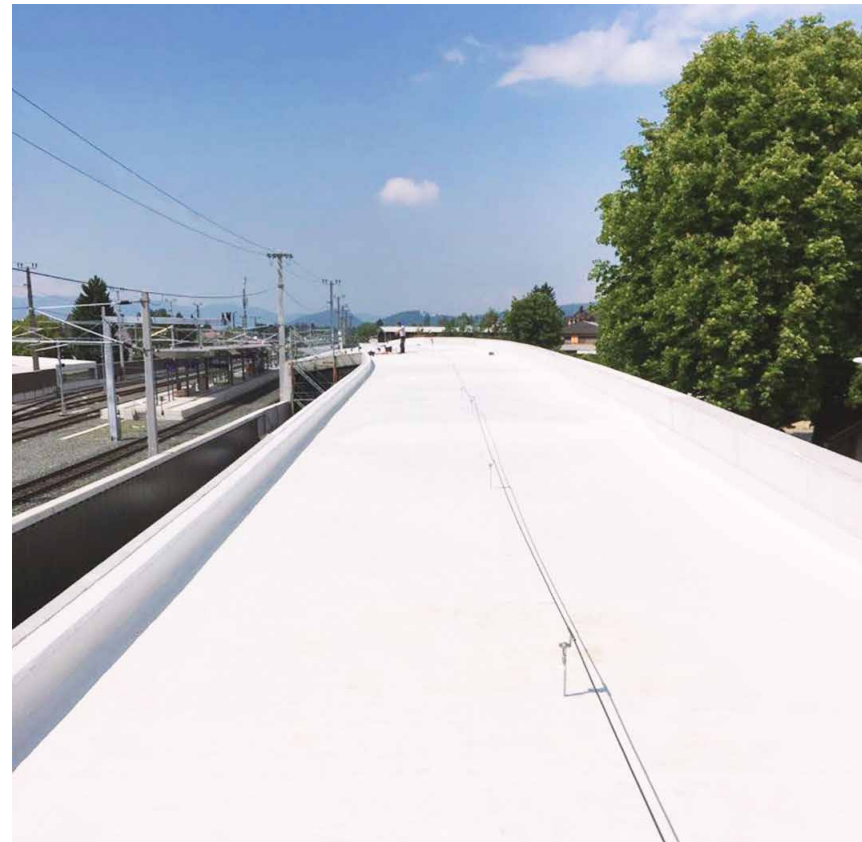
Die umfassenden Arbeiten zur Grundsanierung erstreckten sich über einen Zeitraum von vier Jahren. Der neue Bahnhof bietet nun kurze Wegstrecken, jede Menge Abstellfläche und ein modernes Bahnhofsgebäude.
