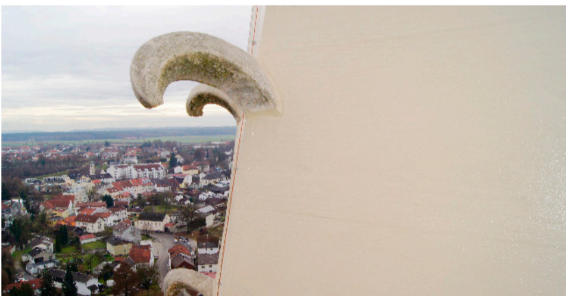
Die steinernen Krabben wurden nicht in die „steinfarbene“ Abdichtung eingebunden.
